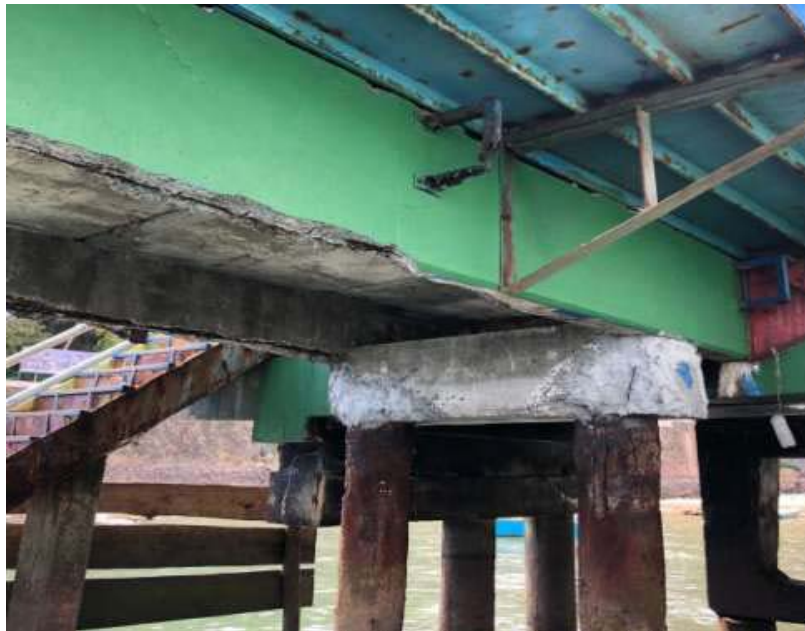
Figura 7 Maior aproximação da foto 03 mostrando destacamento do concreto com exposição das armaduras nas vigas longitudinais (A) e destacamento do concreto nas vigas transversais (B).
