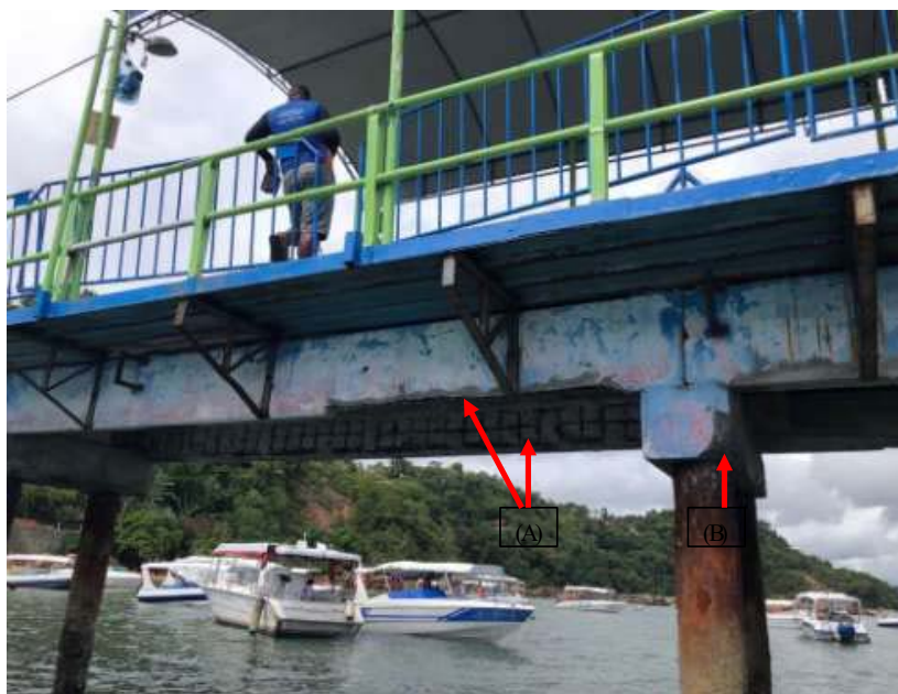
Figura 4 - Maior aproximação da foto 03 mostrando destacamento do concreto com exposição das armaduras nas vigas longitudinais (A) e destacamento do concreto nas vigas transversais (B)
