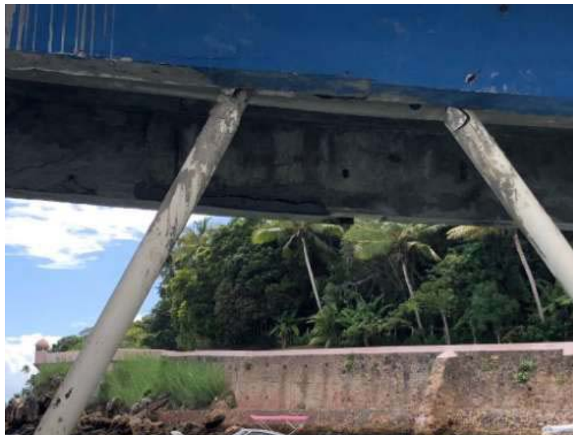
Figura 5 - Mostrando outra região das vigas longitudinais da passarela de acesso, com destacamento do concreto devido à corrosão nas armaduras.
