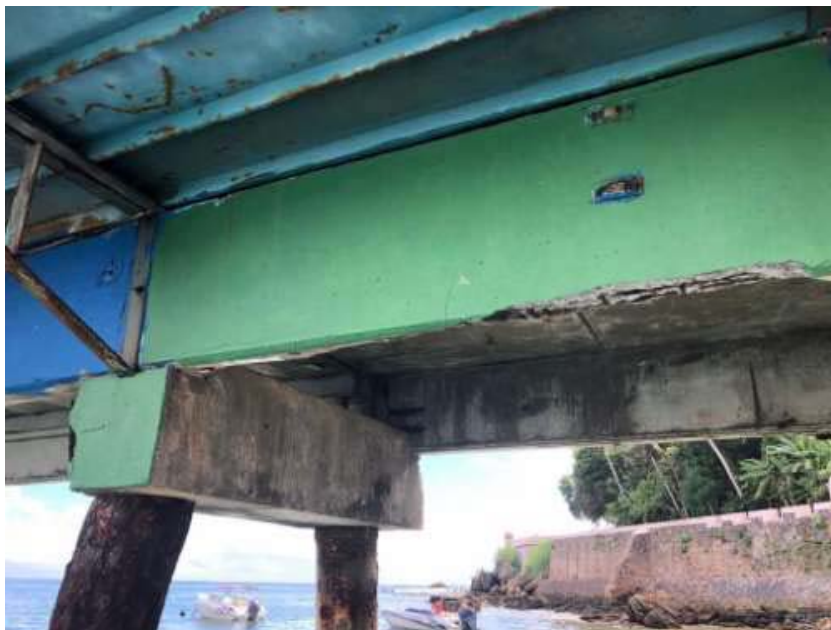
Figura 9 - Mostrando, além do já citado na foto 04, corrosão nas chapas de aço destinadas ao alargamento do piso da passarela de acesso
