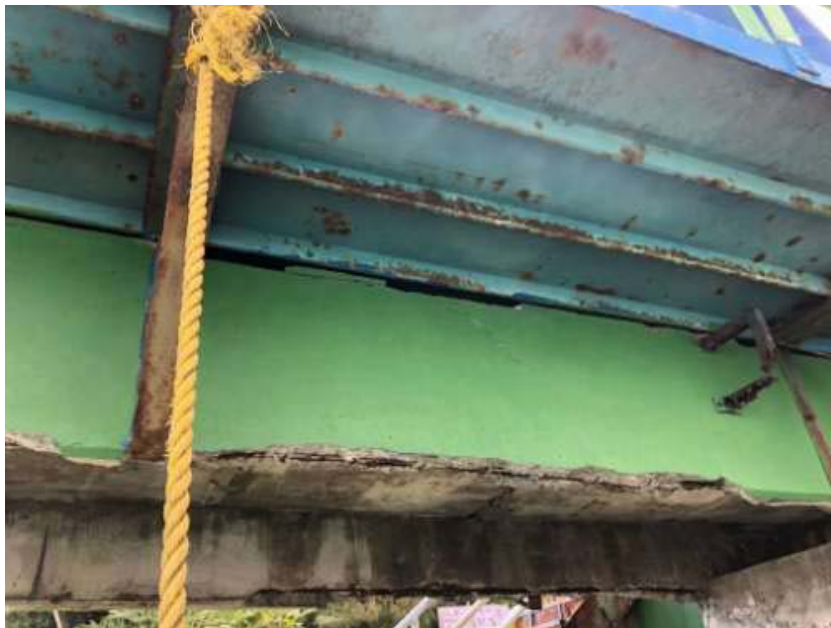
Figura 8 - Mostrando, além do já citado na foto 04, corrosão nas chapas de aço destinadas ao alargamento do piso da passarela de acesso.
