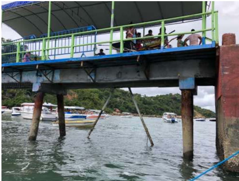
Figura 3 - Maior aproximação da foto anterior para melhor visualização das patologias citadas.
