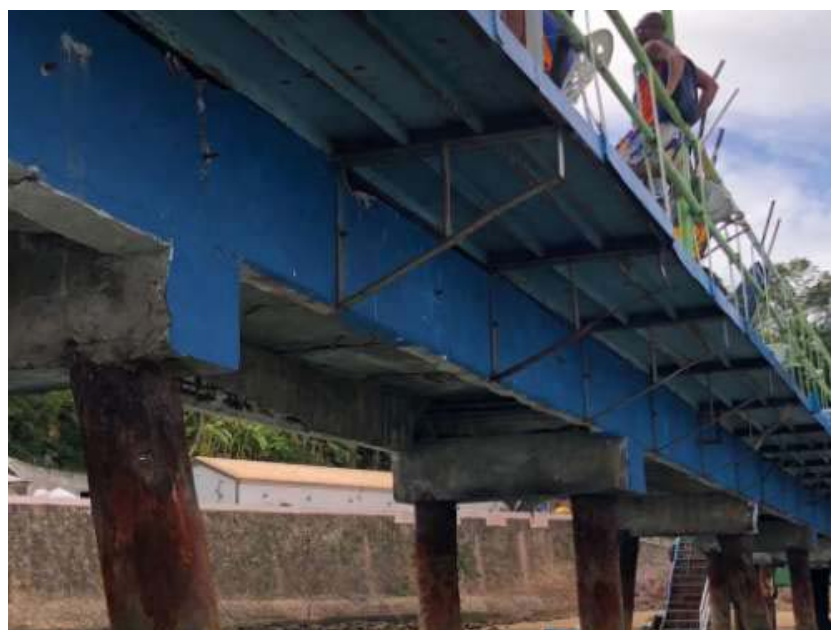
Figura 6 - Maior aproximação da foto 03 mostrando destacamento do concreto com exposição das armaduras nas vigas longitudinais (A) e destacamento do concreto nas vigas transversais (B).
