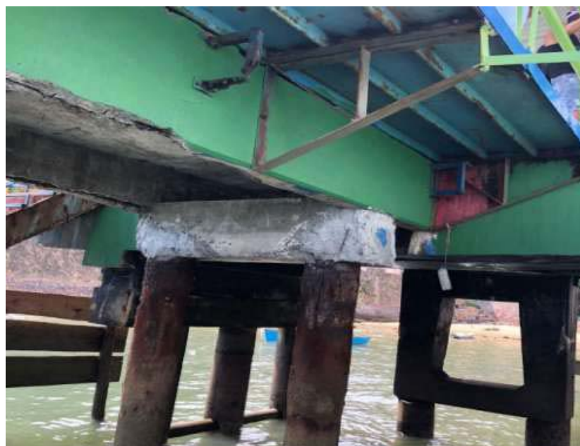
Figura 10 - Mostrando, além do já citado na foto 04, corrosão nas chapas de aço destinadas ao alargamento do piso da passarela de acesso
