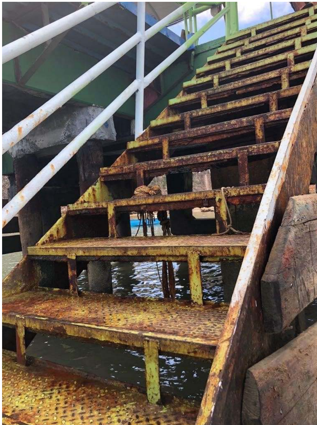
Figura 11 - Mostrando a intensa corrosão na escada de acesso entre a atracação e a passarela de acesso.
