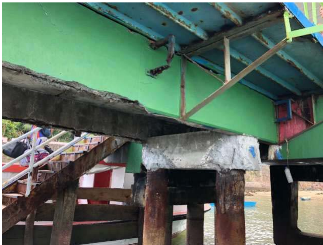
Figura 12 - Mostrando as patologias citadas nas fotos 04 e 11.
