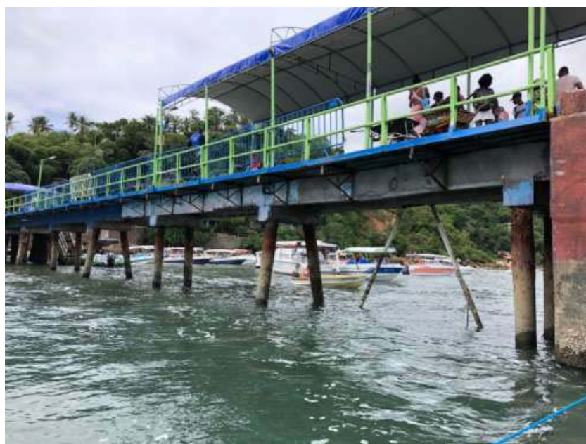
Figura 2 - Vista da Passarela de Acesso ilustrando as patologias de carbonatação no concreto das vigas e corrosão nas armaduras dos pilares.
